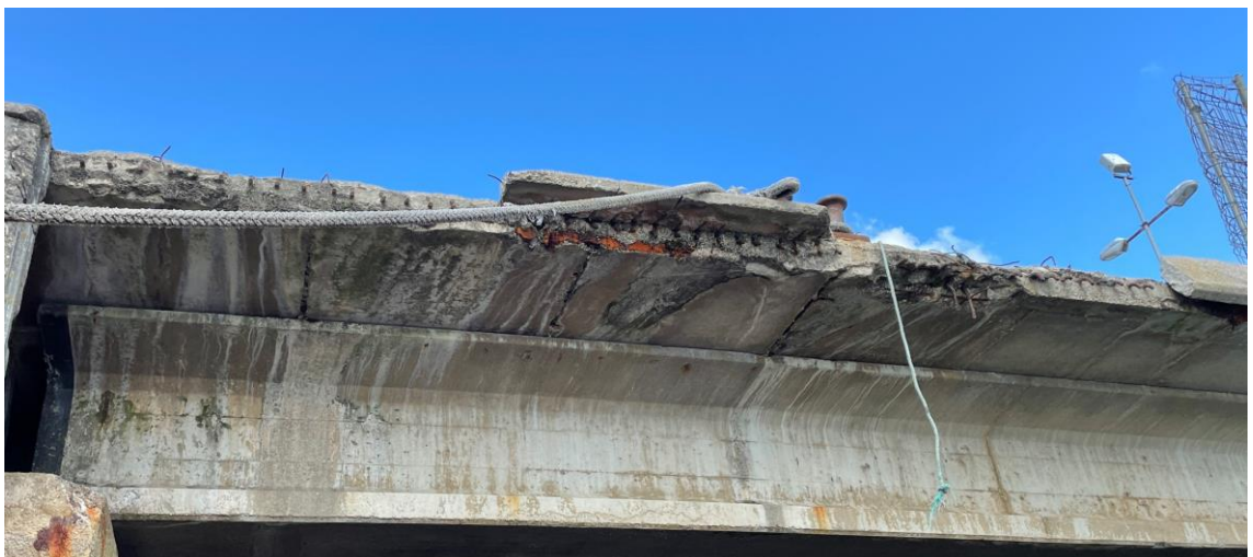
Fig. 5. Coronación de losa ausente o desprendida y zona de bolardos.
