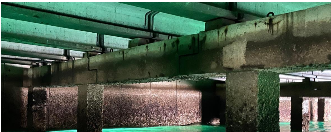
Fig. 12. Estado de los dinteles en vano interior.
