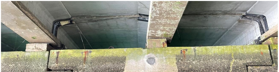
Fig. 9. Vigas doble T desviadas del recrecido del dintel.
