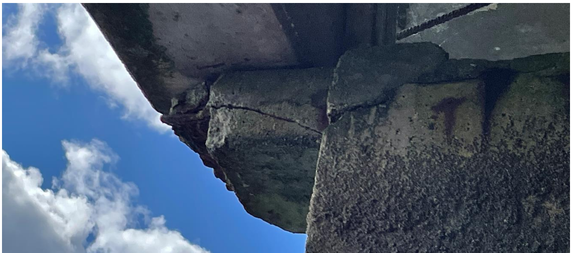
Fig. 14. Ménsula fisurada que sobresale del dintel, de apoyo al panel corto
