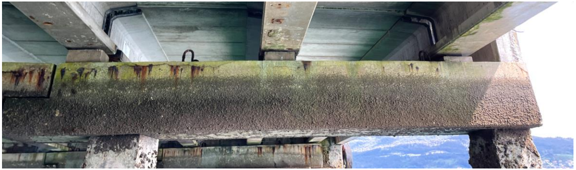
Fig. 13. Estado de los dinteles en vano extremo.
