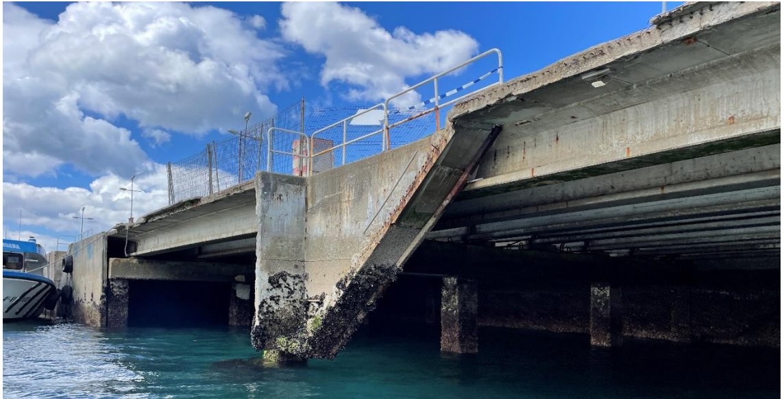
Fig. 16. Vista lejana de la escalera en la zona del desprendimiento de los paneles laterales.
