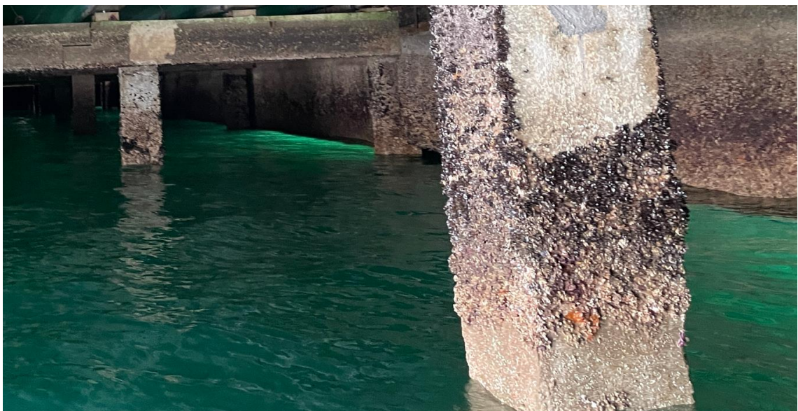
Fig. 7. Estado de una de las pilas en la zona interior del muelle.
