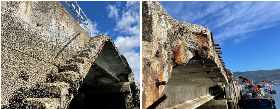
Fig. 1. Elementos a demoler: escaleras de acceso y borde de la capa de compresión.
