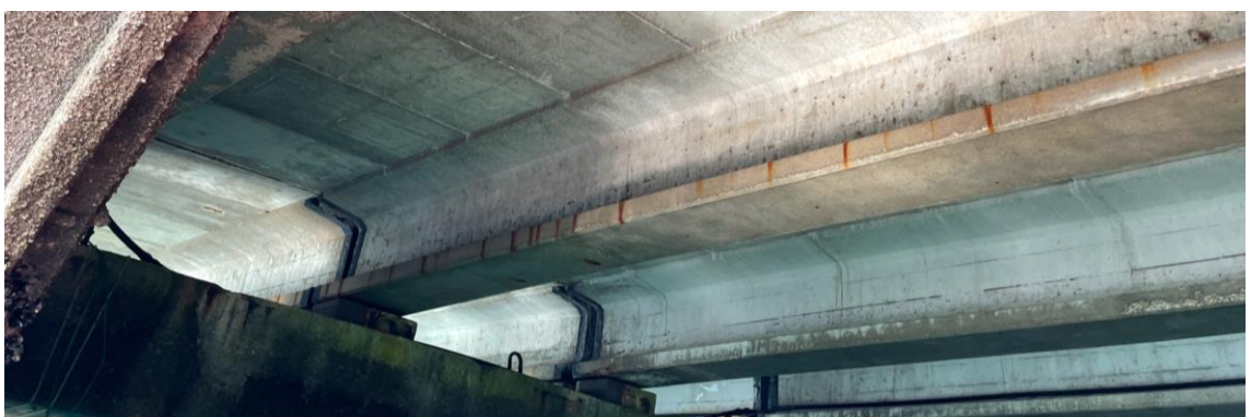
Fig. 10. Afloramiento de manchas de óxido en las vigas doble T.
