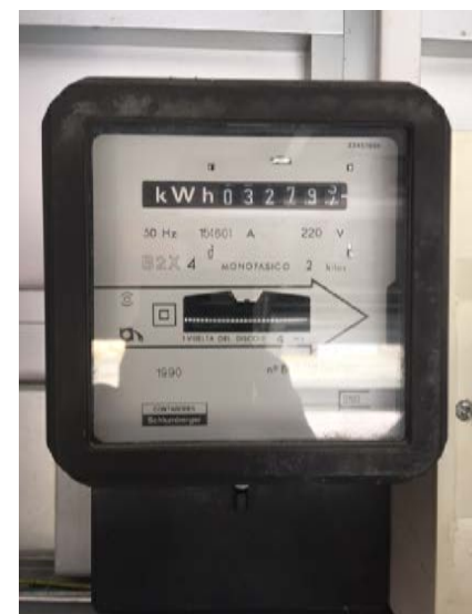
CONTADOR ENERXÍA Nº B10204730
