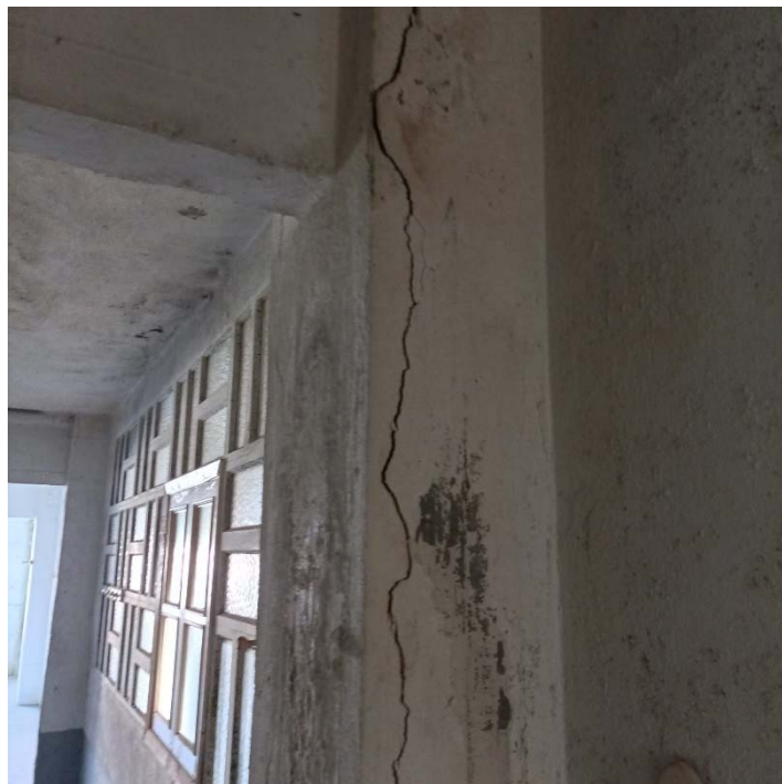
Pilares que necesitan reparación.
