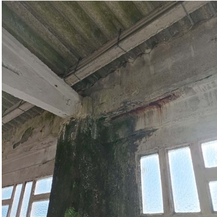
Viga que necesita reparación.
