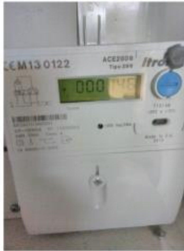
CONTADOR ENERXÍA Nº 13400509Z
