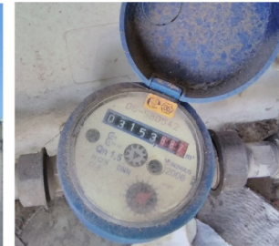
CONTADOR NAVE 3 ABASTECIMENTO
