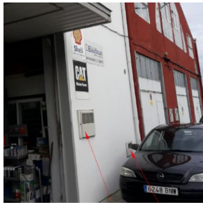
CONTADOR ENERXIA CONTADOR ABASTECIMENTO
