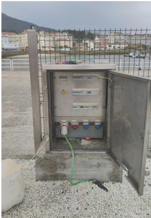
ARMARIO ENERXÍA CGP EXISTENTE
