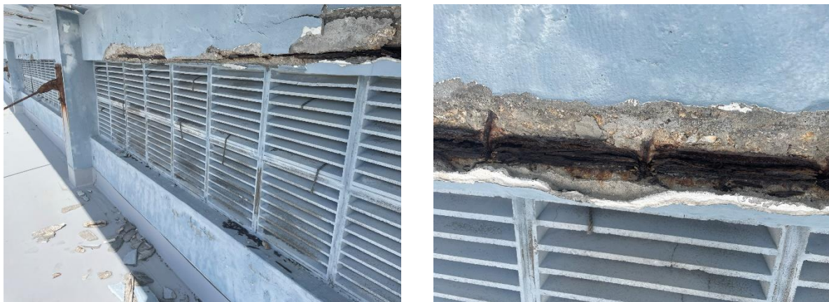
Figura 30. Distintos desperfectos en elementos de hormigón armado.
