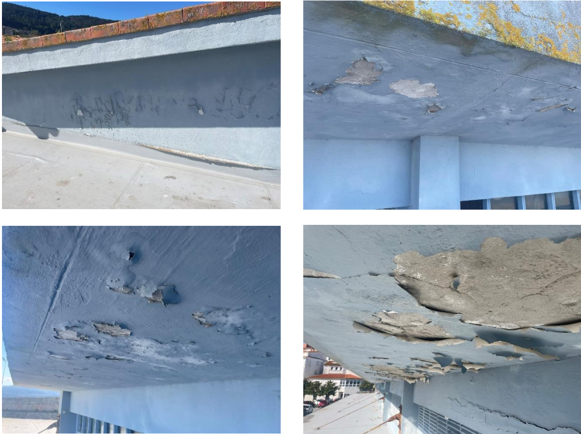
Figura 31. Distintos desperfectos en pintura de fachadas y voladizos..
