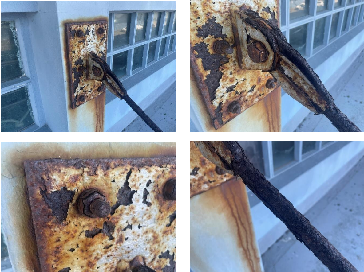
Figura 27. Placa de anclaje y tirante que soporta voladizos en fachadas norte y sur.
