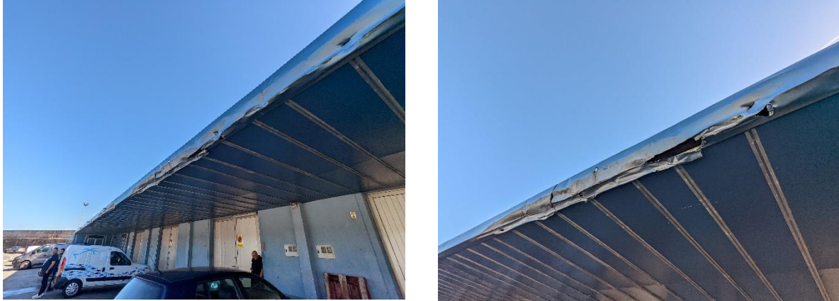
Figura 29. Desperfectos en chapa de remate de voladizo.
