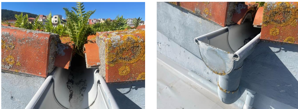
Figura 22. Encuentro de canalón con bajante en fachada este.
