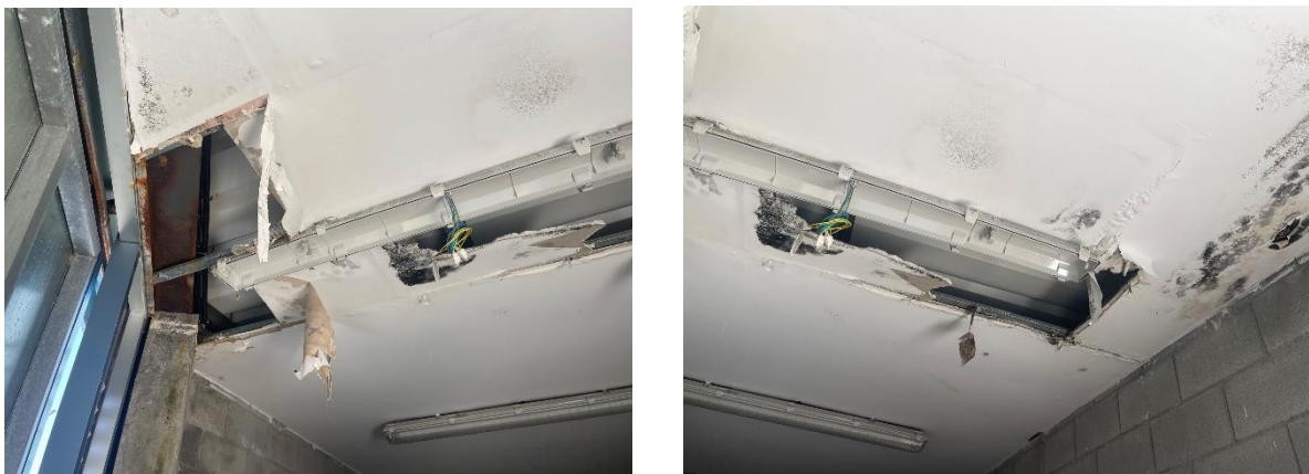
Figura 26. Manchas y desconchados en techos interiores por filtraciones de cubierta plana.
