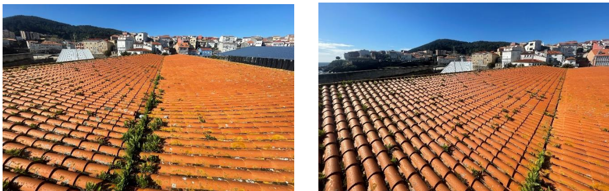
Figura 32. Ausencia de medios de protección en cubierta de teja cerámica.
