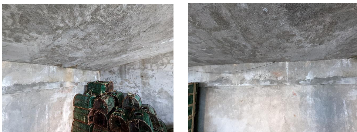
Figura 23. Estado de la cara inferior de la losa de cubierta.
