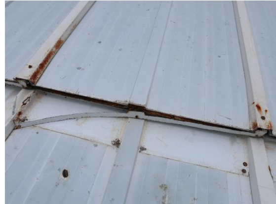
Figura 8. Imagen de desprendimiento de piezas de cierre en cubierta
