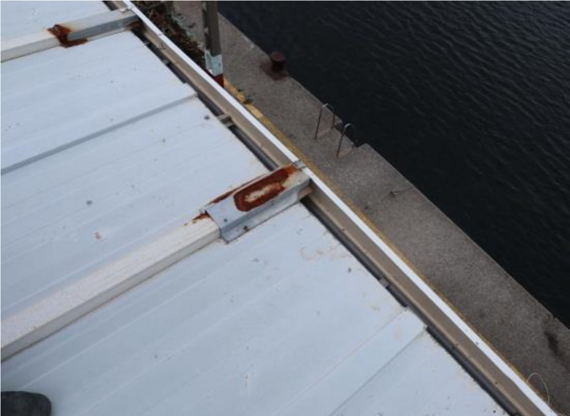
Fig.5. Imagen de canalón de cubierta actual.
