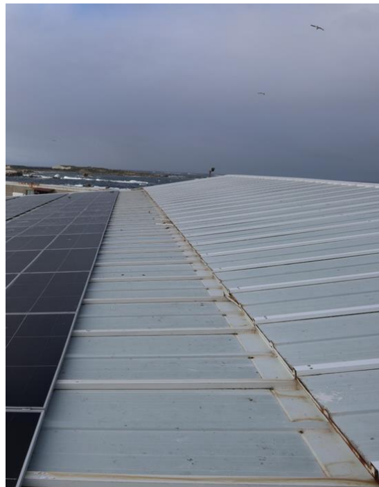
Pérdida de los remates del canto y oxidación
