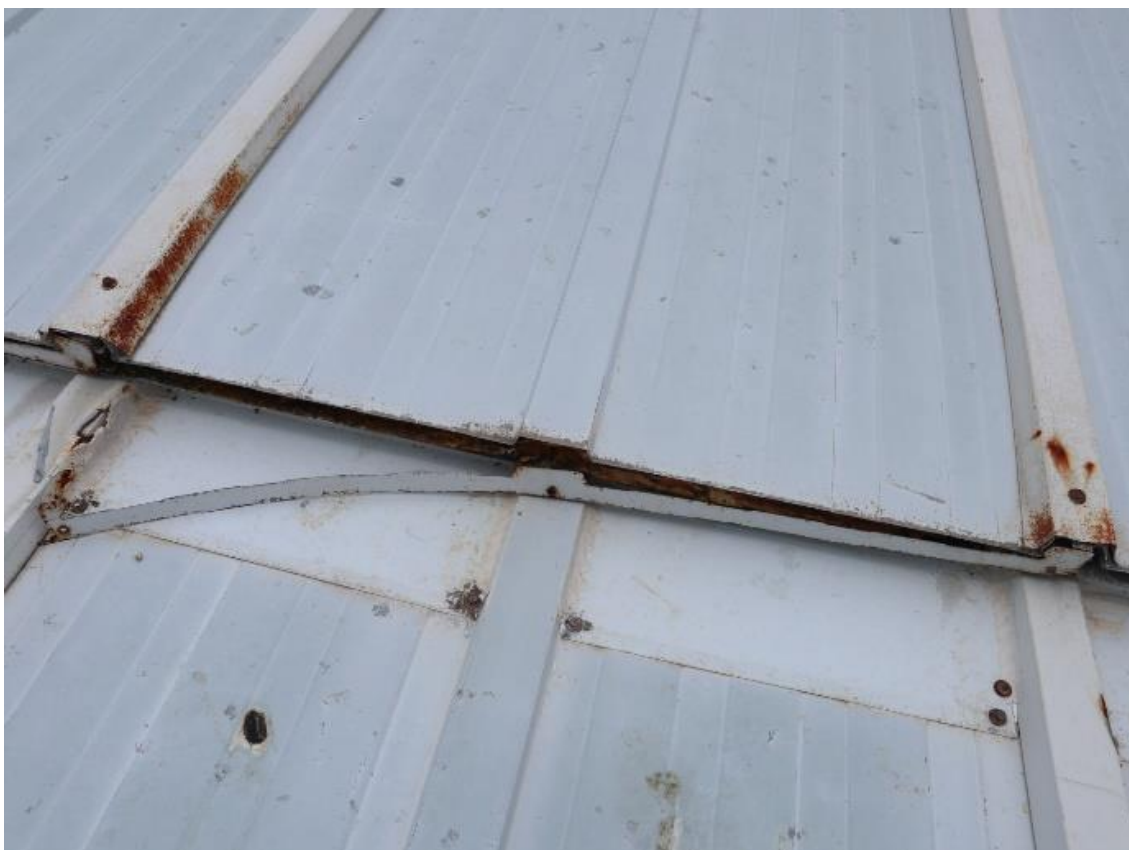
Fig.4. Imagen de desprendimiento de piezas de cierre en cubierta.
