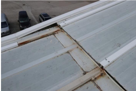
Figura 5. Imagen encuentro de cambio de pendiente de cubierta cubierta
