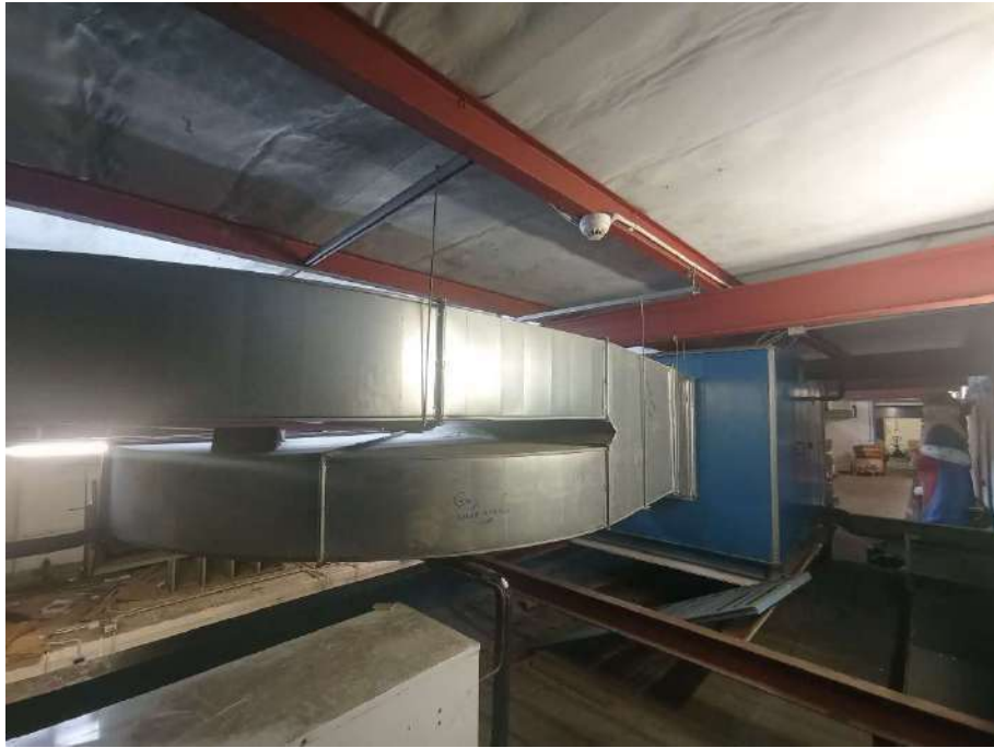
Unidad de climatización actual a desmontar
