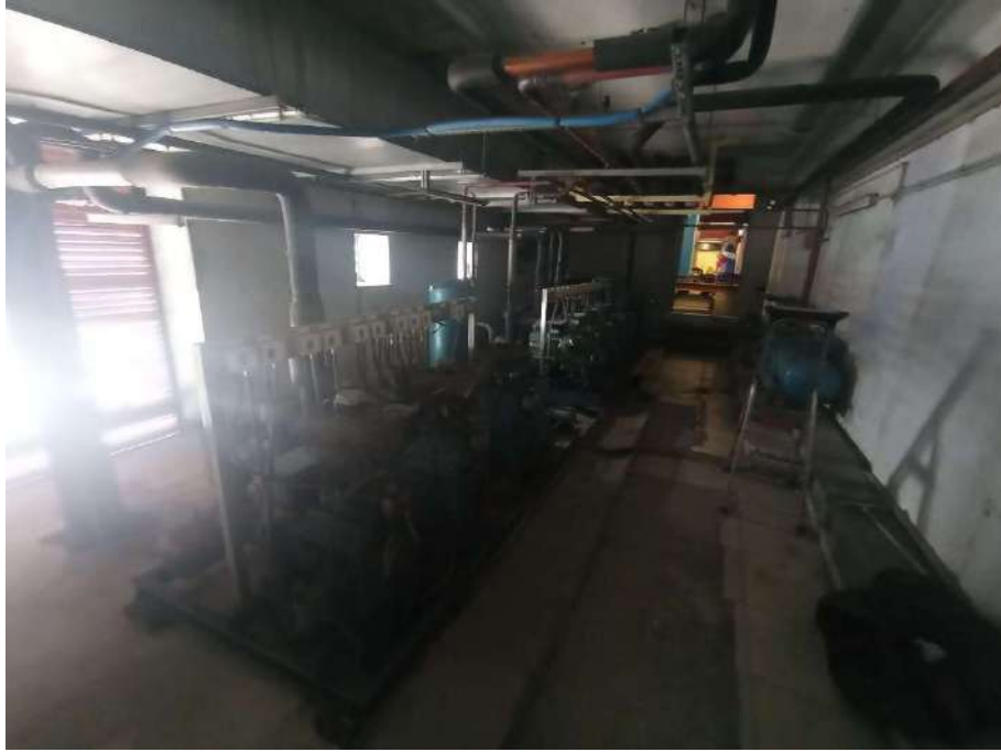
Cuarto de equipos frigoríficos. Central frigorífica a renovar
