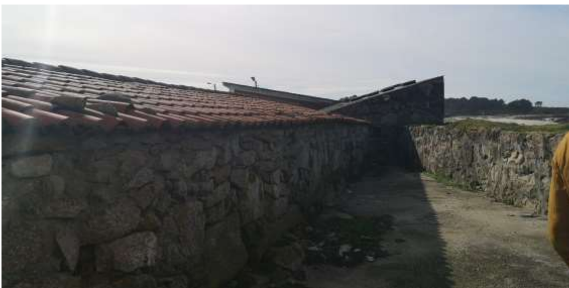
Imagen 34. Parta trasera de las viejas edificaciones situadas en la entrada del puerto. Fuente: ACADAR
