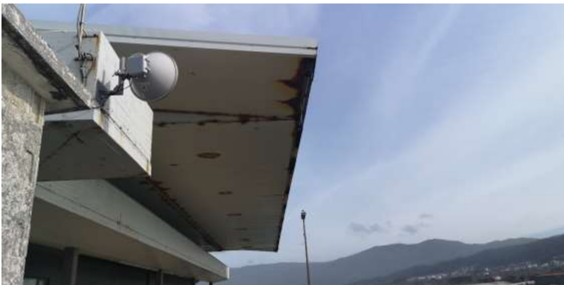
Imagen 26. Estado actual de la cubierta en la fachada sur de la lonja. Fuente: ACADAR
