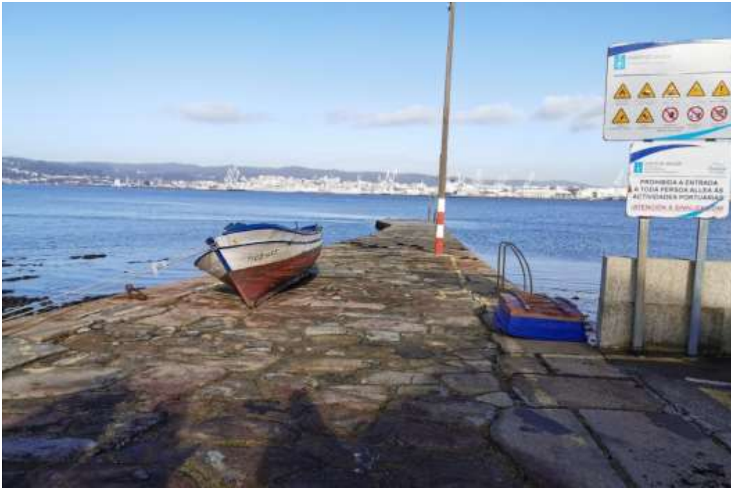
Imagen 47. Vista general de la rampa que constituye el puerto de O Seixo. Fuente: ACADAR
