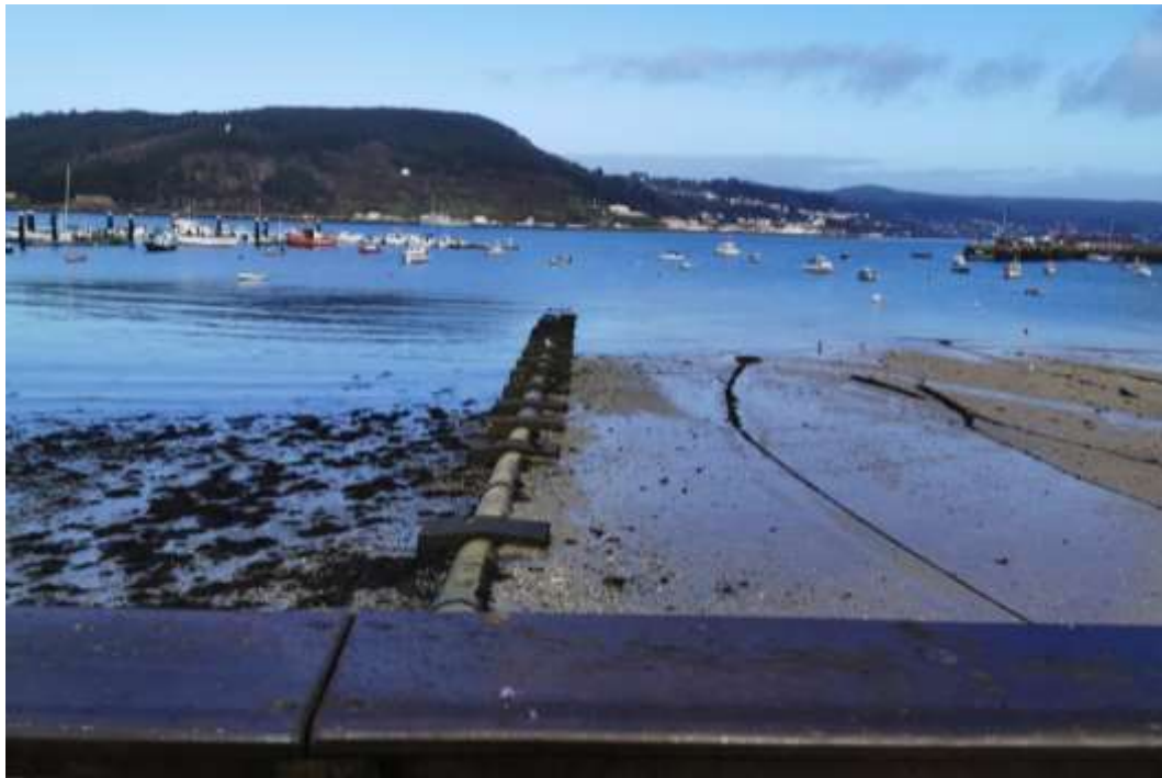
Imagen 22. Emisario situado dentro de la zona de servicio del puerto de Mugardos. Fuente: ACADAR
