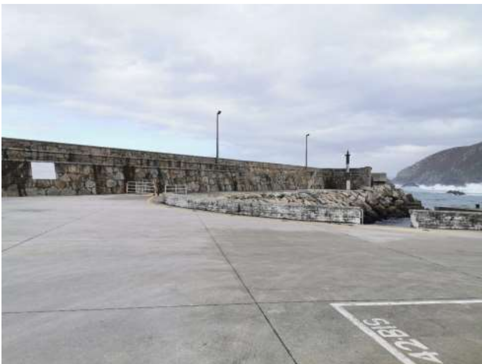
Imagen 18. Parte interior del dique de abrigo del puerto de Caión y explanada anexa. Fuente: ACADAR
