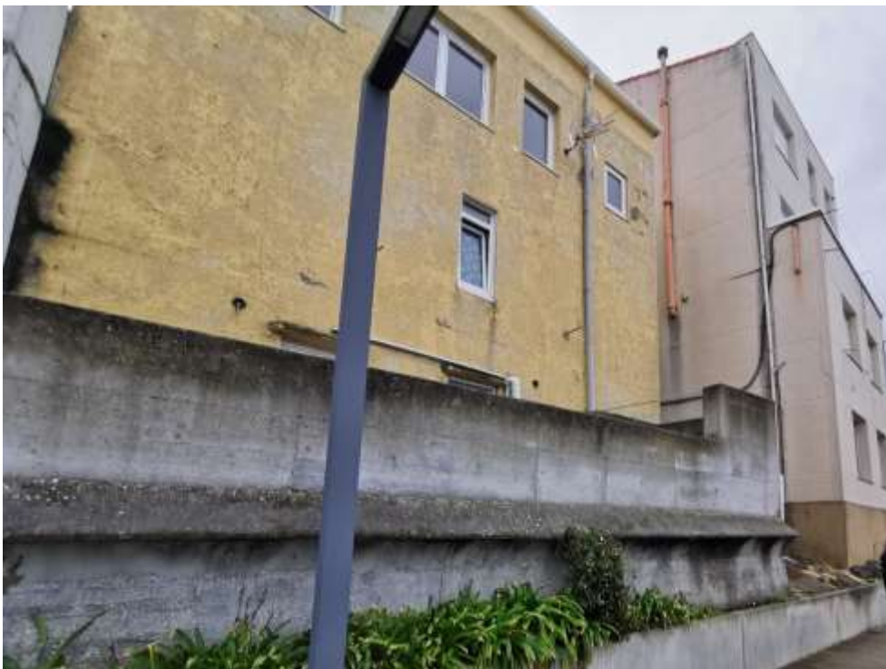
Imagen 22. Terraza que invade DPMT y está fuera de la parcela catastral. Fuente: ACADAR
